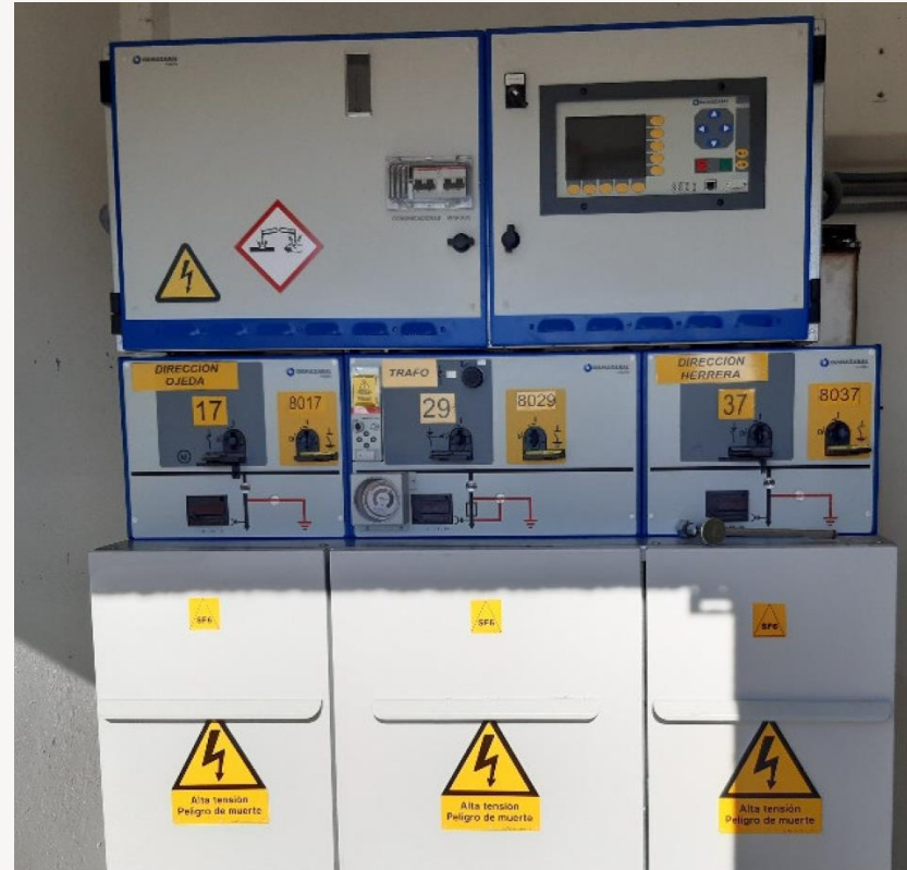
Automatisierte MSP Schaltanlage
