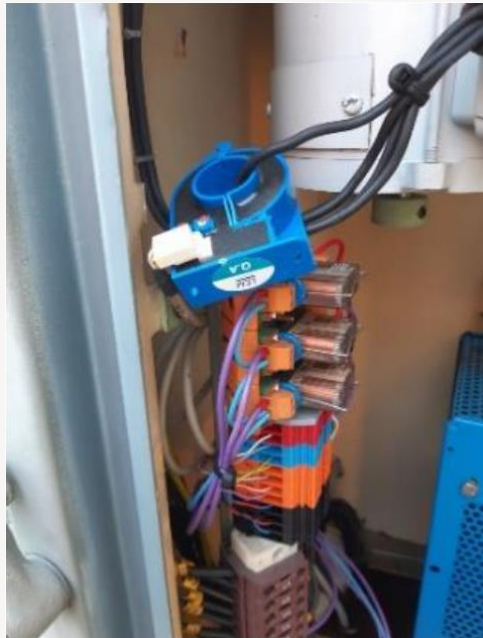
Strom Klappsensor installiert in Stufensteller Motorschrank
