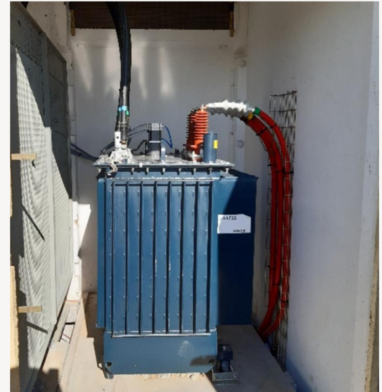
Transformator mit Online Stufensteller
